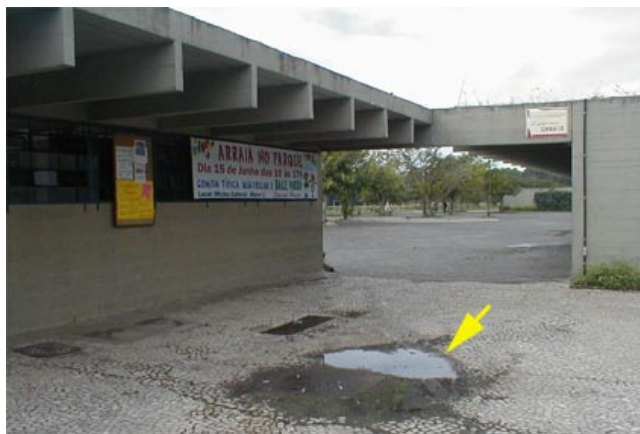
Acúmulo de água e sujeira (02/06/2008)
